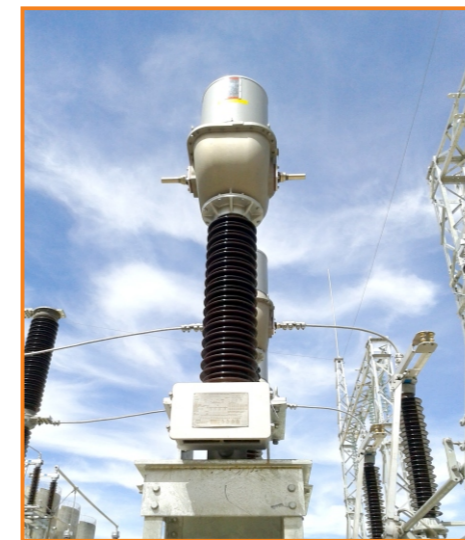
Biến dòng điện 110kV 110kV current transformer
