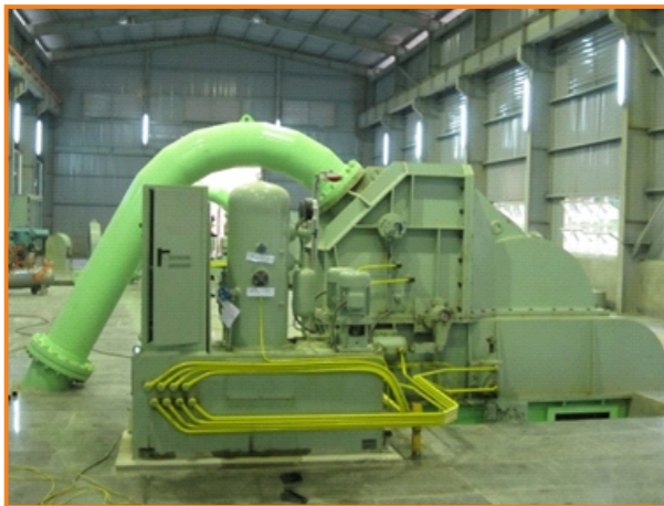
Tổ tua bin gáo Nhà máy thủy điện Đambol, Lâm Đồng Pelton turbine installed in Dambol HPP
