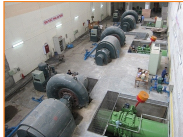
Tua bin Francis trục ngang nhà máy thủy điện Ayun Thượng 1A, Gia Lai Horizontal shaft francis turbine intalled in Ayun Thuong 1A HPP
