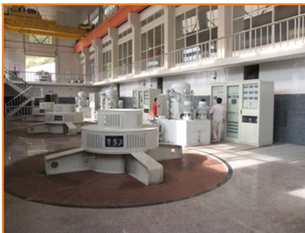
Tua bin Francis trục đứng Thủy điện H'Chan, Gia Lai Vertical shaft Francis turbine installed at Hchan HPP
