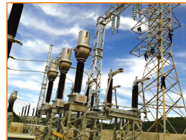
Biến dòng điện và dao cách ly 110kV 110kV current transformer and disconnector
